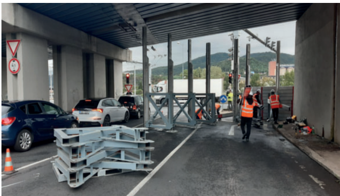
Stavba mobilního PPO hrazení na levém břehu Labe v Ústí nad Labem
