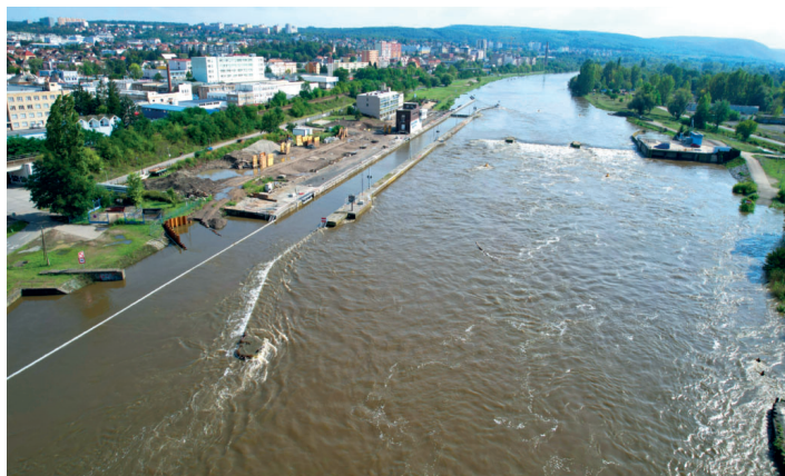
Rozvodněná Vltava narušila rekonstrukci plavební komory Modřany (17. září 2024)
