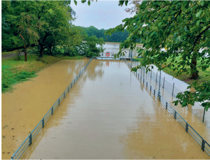
Zaplavená plavební komora Nedakonice
