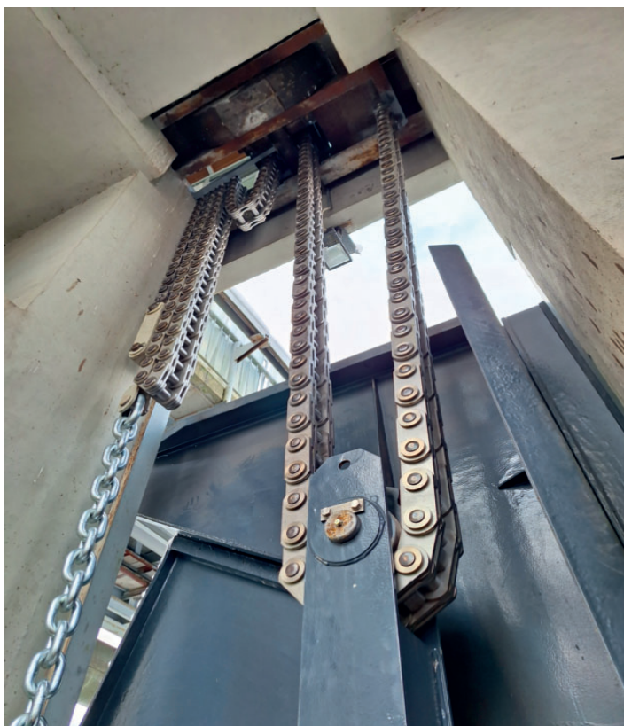
Pohled na soustavu Gallového a článkové řetězu
