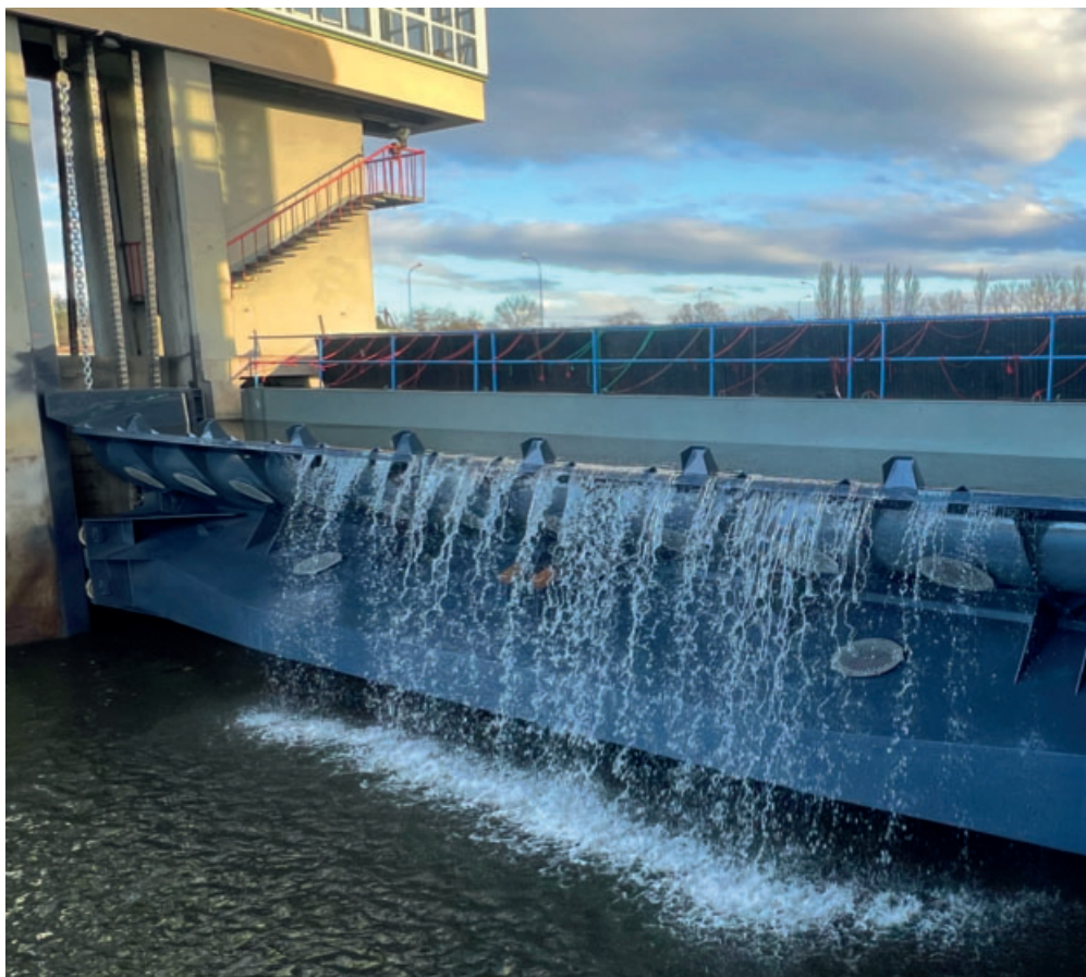
Levé jezové pole – uvádění do provozu
